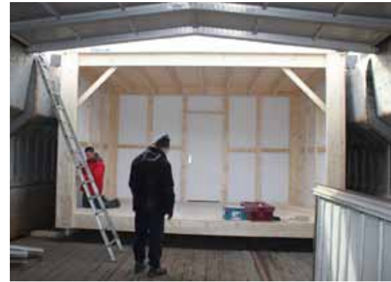
De module, gezien in het ruim van de kempenaar, ongeveer 40 cm boven het ruimvlak. Je kunt er aan beide kanten langs lopen, wat latere montage van leidingen, kabels en wandisolatie eenvoudig mogelijk maakt. (foto Nerine Iken).
