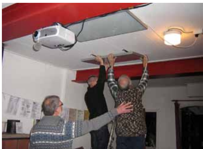
De stralingspanelen worden aan het plafond van de 'bakkerij' bevestigd door v.l.n.r. Rik van Schuur, Matthieu van Bragt en Sjaak Herman. Rik en Sjaak zijn leden van de reparatieclub W.Z.Vl., die regelmatig in de 'bakkerij' bijeenkomt. Matthieu is technisch vrijwilliger van de Stichting.
