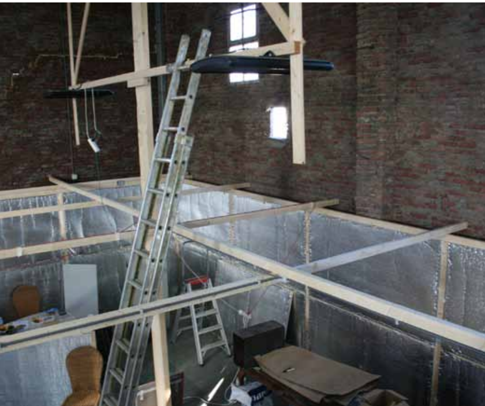
In het gebouw waar iedere isolatie ontbreekt volstaat een opstelling van schermen rond een werkvloer gemaakt van houten constructieplaten. De schermen bestaan uit ramen van dunne latten bespannen met noppenfolie met aluminiumlaag.
